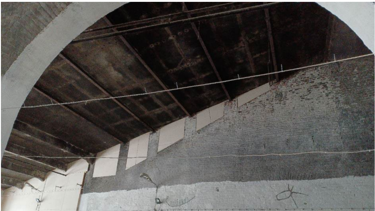
Kuva 103. Seinässä näkyy vanhoja, umpeen muurattuja ovi- ja ikkuna-aukkoja. Tämäkin seinä on ilmeisesti ollut ulkoseinänä muutaman vuoden ajan. Kattokulmaa on muutettu laajennusosan rakentamisen yhteydessä, mistä näkyy jäljet seinässä.
