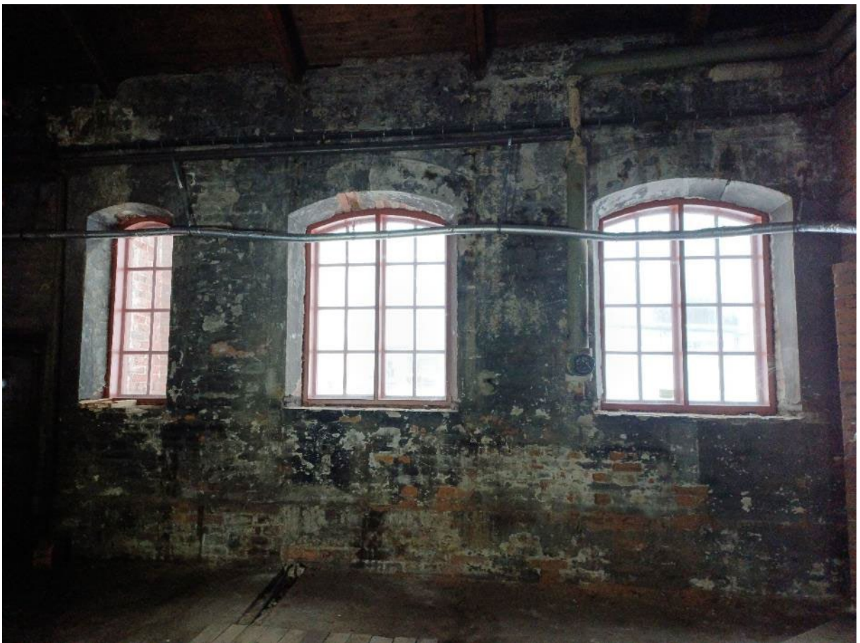
Kuva 80. Ikkunat on uusittu 1980-luvulla, mutta ikkuna-aukkojen muoto sekä ulkopuitteiden ruutujako on alkuperäinen. Valkoisiksi kalkatut seinät ovat tummuneet noesta.
