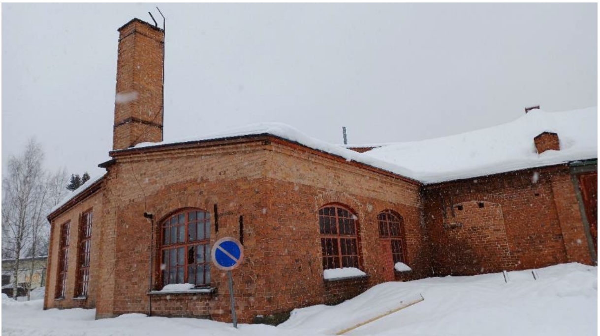
Kuva 45. Rakennuksen itäpuolta, 1908 rakennettua osaa. Keskellä entinen sauna/pannuhuone ja viimeksi rakennetut pilttuut oikealla. Vasemmalla näkyy 1940-luvun laajennus.
